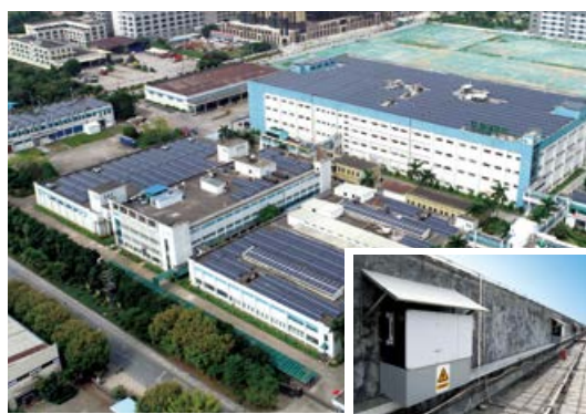
广东三水 2.5MW 工业屋顶光伏电站
