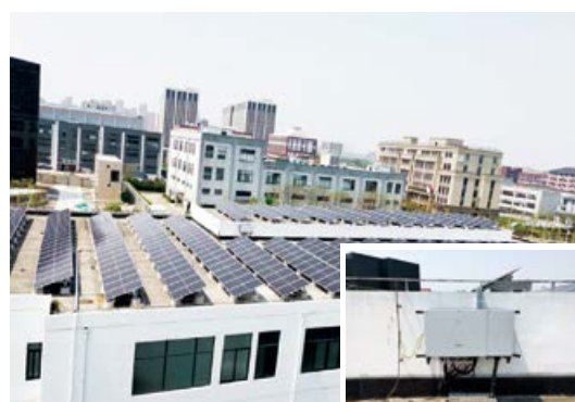
国药集团 196kW 工业屋顶光伏电站
